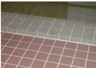
浴室床タイルの破損
