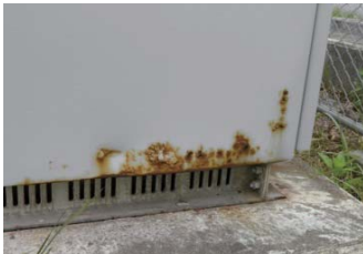
キュービクル外装の錆
