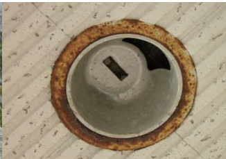
軒下ダウンライトの破損
