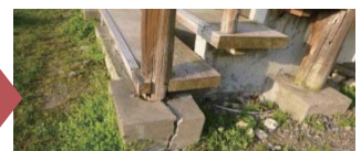
手すり支柱ブロック割れ
