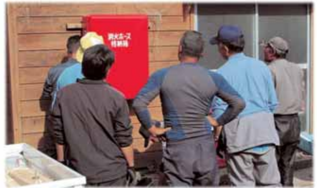
※設置した消火栓用格納箱
