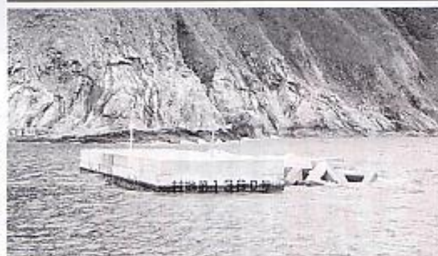
工事が中断された福浦漁港東第2防波堤
