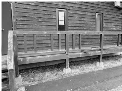
腐食が進む森林体験館のウッドデッキ
